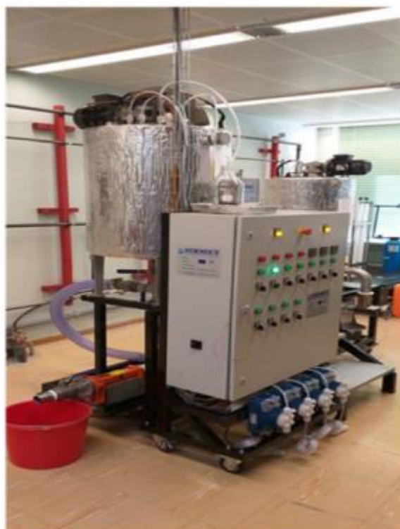
Fig. 3. Instalatia pilot construita de firma SIRMET
